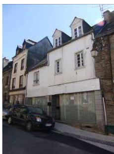
Bâtiment menaçant péril
