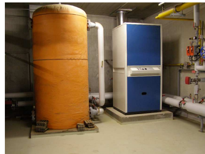
Chaudière à basse température
