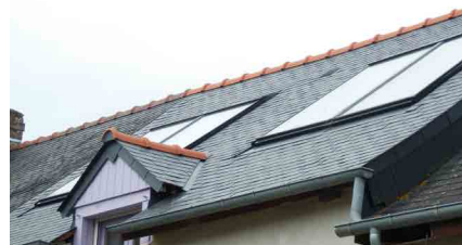
La nécessaire réfection de la toiture a permis d'inclure dans le projet l'intégration de panneaux solaires thermiques.
