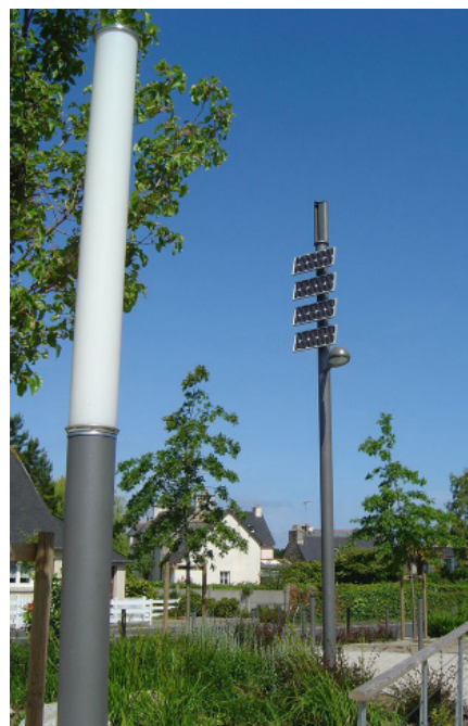
Un lampadaire autonome en énergie.
