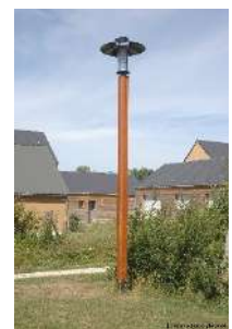
Mât qui favorise l'éclairage du sol - Hédé-Bazouges (35)
