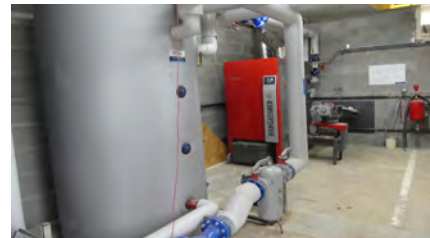
Mise en service en 2019, la nouvelle chaudière bois chauffe 6 bâtiments communaux
