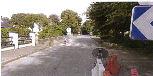
Aménagement de chicanes dans le rue pour réduire la vitesse des automobilistes.
