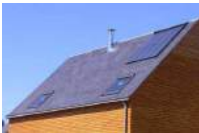
Chauffe eau solaire
